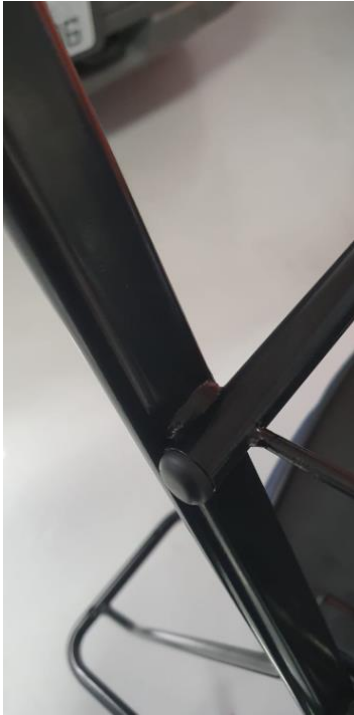
Imagem 19 – solda de apara do gradil porta objetos sob assento em detalhe vista 3
