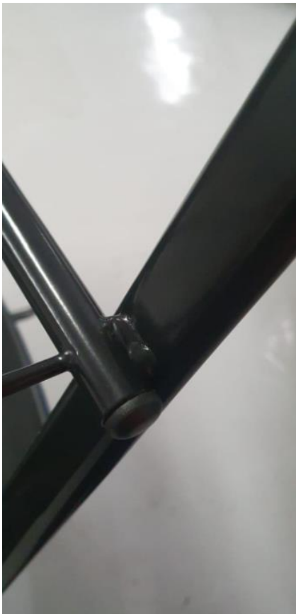
Imagem 18 – solda de apara do gradil porta objetos sob assento em detalhe vista 2
