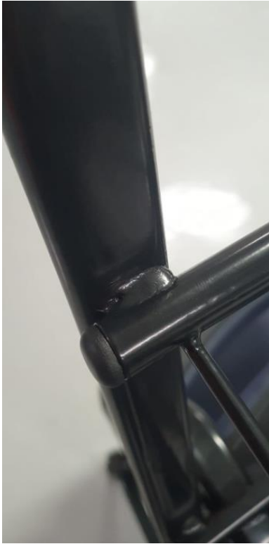
Imagem 17 – solda de apara do gradil porta objetos sob assento em detalhe vista 1
