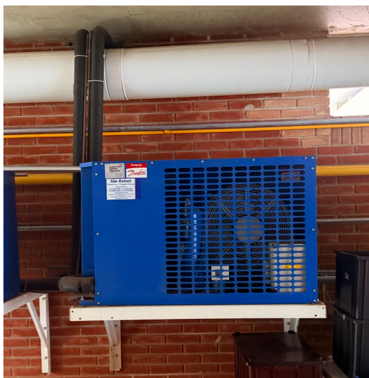
Figura 1 — Unidade condensadora Danfoss instalada em área técnica.
