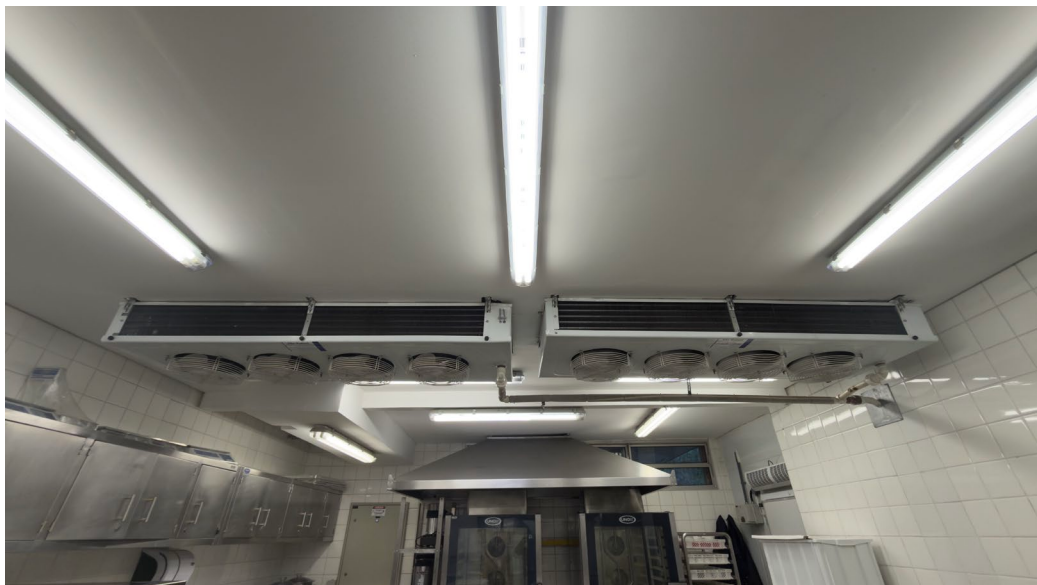
Figura 3 — Unidades evaporadoras instaladas no teto da Cozinha Pedagógica.
