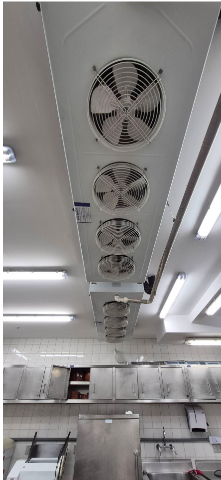
Figura 4 — Detalhe dos motoventiladores da unidade evaporadora.
