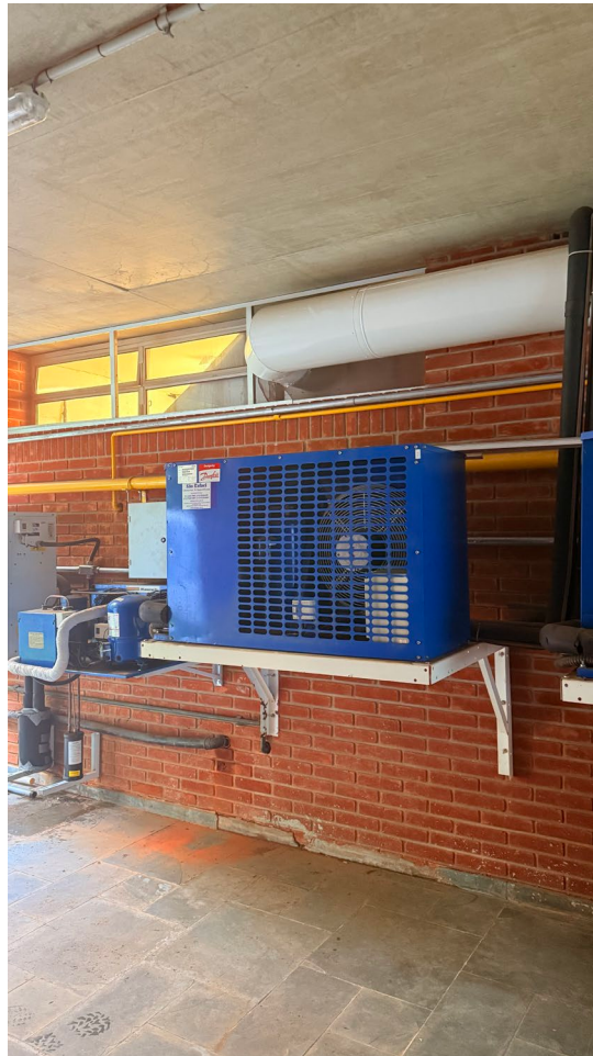
Figura 2 — Vista geral da área técnica com a unidade condensadora e demais equipamentos da casa de máquinas.
